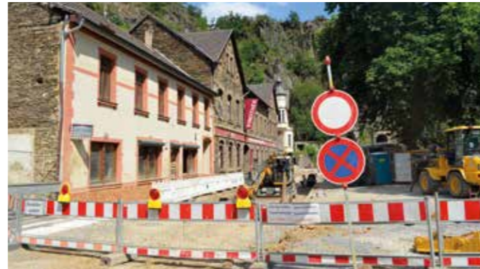
Die betroffenen Orte sind noch nicht überall wieder durchgängig. Wie hier in Altenahr, wo derzeit Kanalarbeiten erfolgen.
