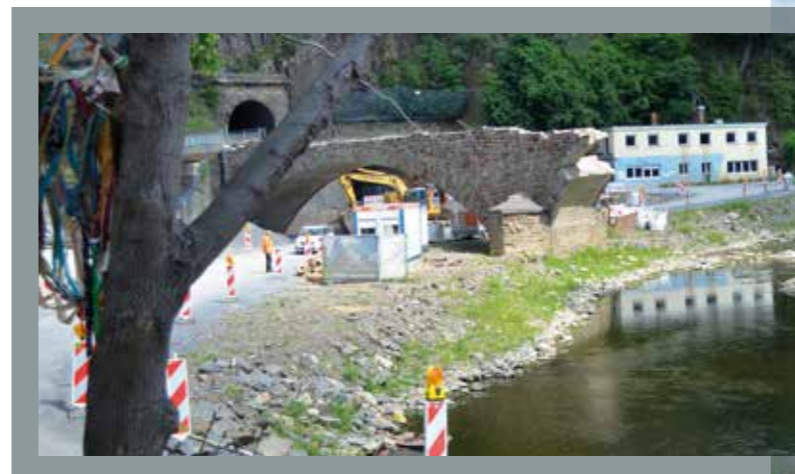
Brücken sind zum Teil provisorisch aufgebaut, doch so manche Brücke liegt noch in Trümmern.
