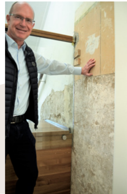
Dr. Reinhard Mevis zeigt an einer Stelle in der fertig sanierten Praxis, wie hoch das Flutwasser war.
